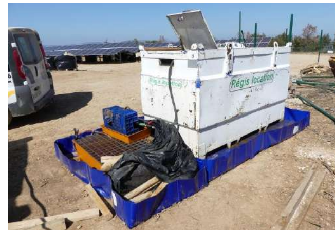
Tous les contenants de produits polluants doivent être placés sur des bacs de rétention ou sur une plateforme étanche adaptée - DRYOPTERIS, 2017
