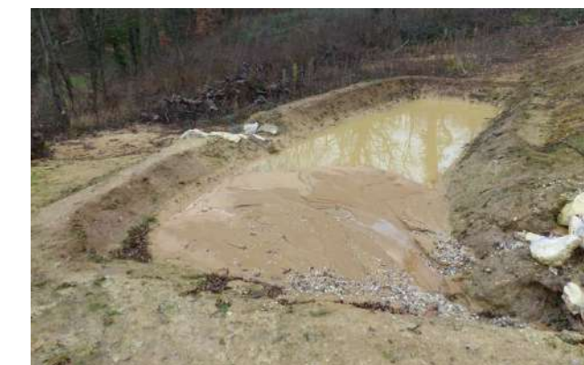
Bassin de rétention ayant permis la rétention d'une importante quantité de fines et nécessitant un curage – DRYOPTERIS 2017
